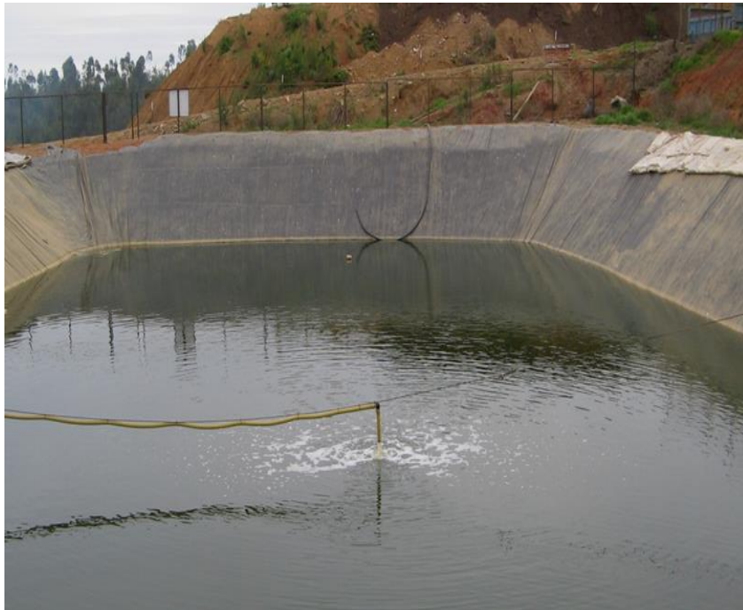
FIGURA 12 TANQUE DE REACCION DE LIXIVIADOS
